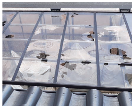
▲雹が貫通して破損したカーポート屋根
